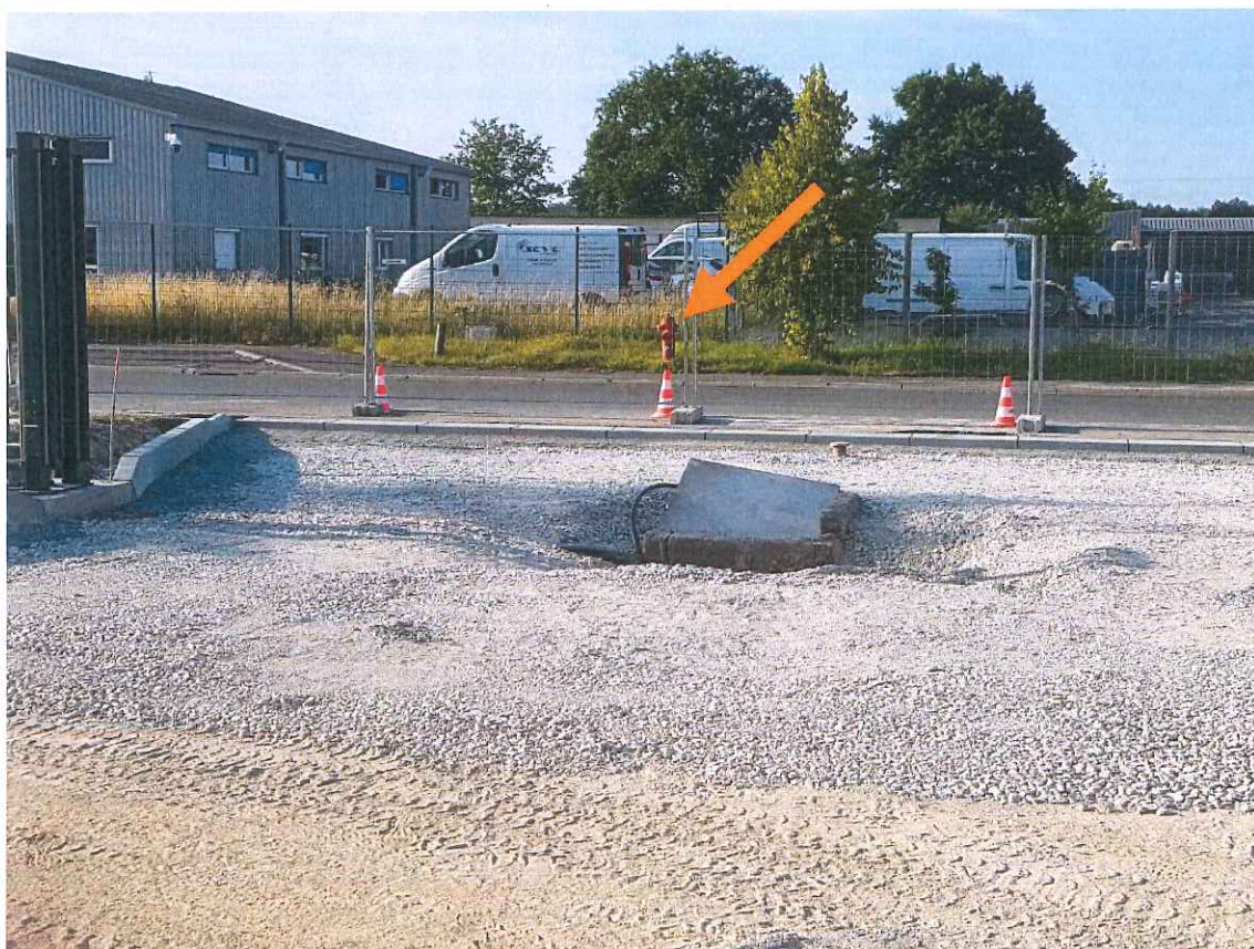
MENUT ST CYR EN VAL – Poteau Incendie sur le trottoir en face l'entrée principale (Vue 1)
