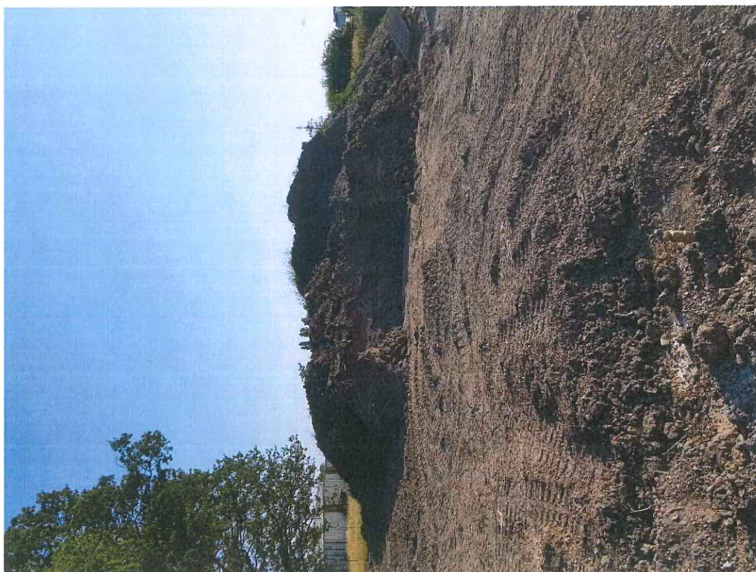
MENUT ST CYR EN VAL : Merlon terres marquées au Pb et au Cu au deuxième plan. Terre végétale au premier plan.
